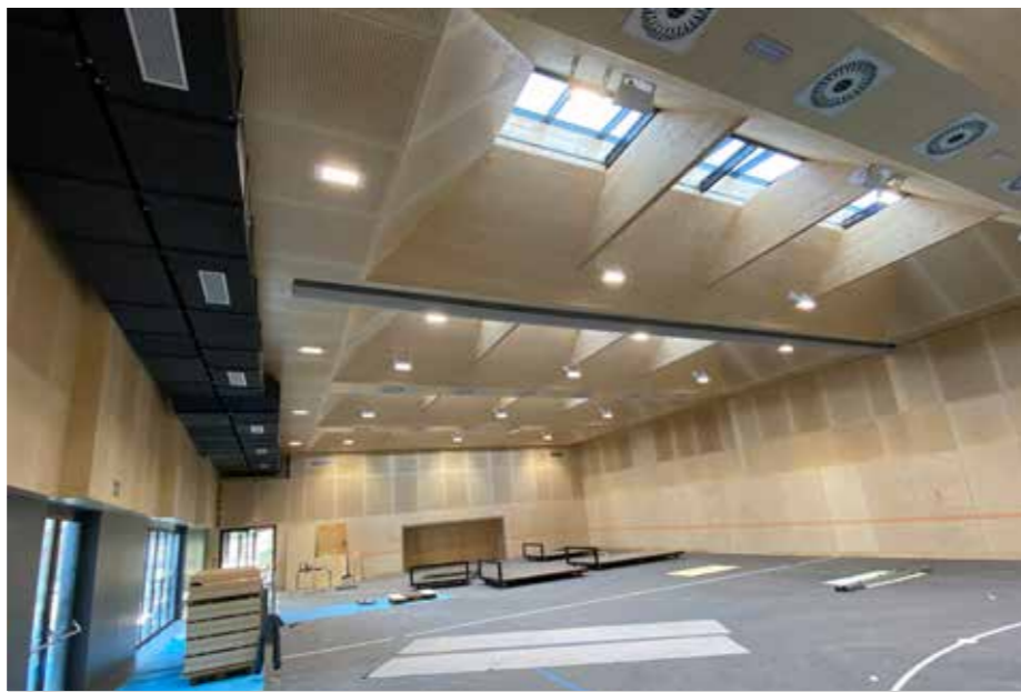
Mit dem Lüftungssystem kann die Sport- und Kulturhalle geheizt und gekühlt werden.
