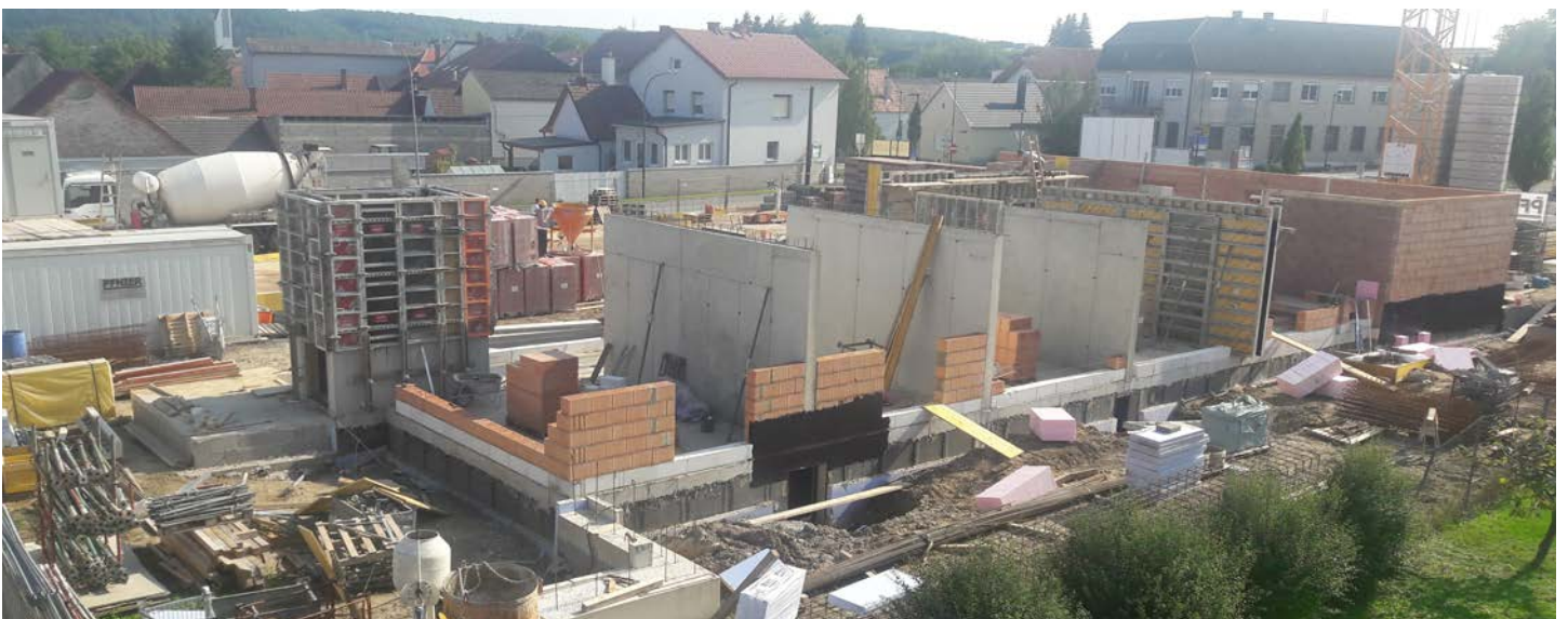
Der Bauverlauf des Pflegezentrums ist im Plan. Ziel der Inbetriebnahme ist Frühjahr 2021.
